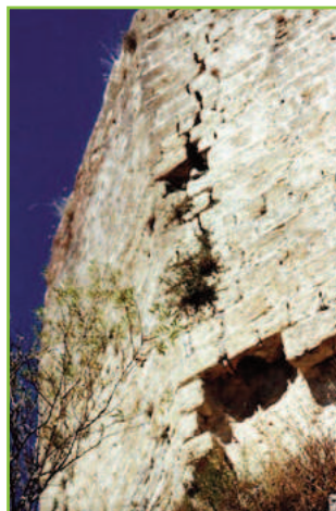
Fissure sismique, Donjon St Maime, G. Poursoulis 2003
